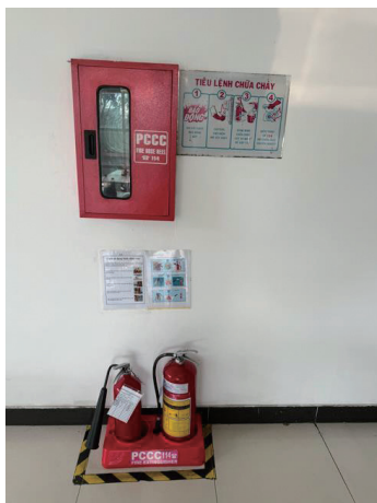
廠房區域內的防火設備
