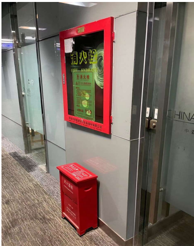
在中亞烯谷深圳辦公室安裝的消防設備
