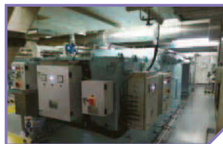
钻井平台生活污水处理装置
