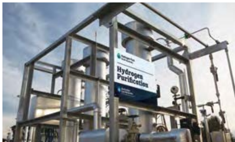
於二零二一年五月，Australian Gas Networks 啟動旗下首個氫氣生產設施 Hydrogen Park South Australia，並開始在阿德萊德部分天然氣配送網絡加入再生氫氣。
