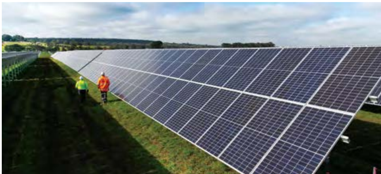
Victoria Power Networks 旗下 Beon 完成興建六十二兆瓦的 Jemalong 太陽能發電場、一百零六兆瓦的 Yatpool 太陽能發電場，以及十二兆瓦的墨爾本機場太陽能發電場，其中墨爾本機場項目乃澳洲設置於儀表板後端的最大型太陽能發電裝置之一。
