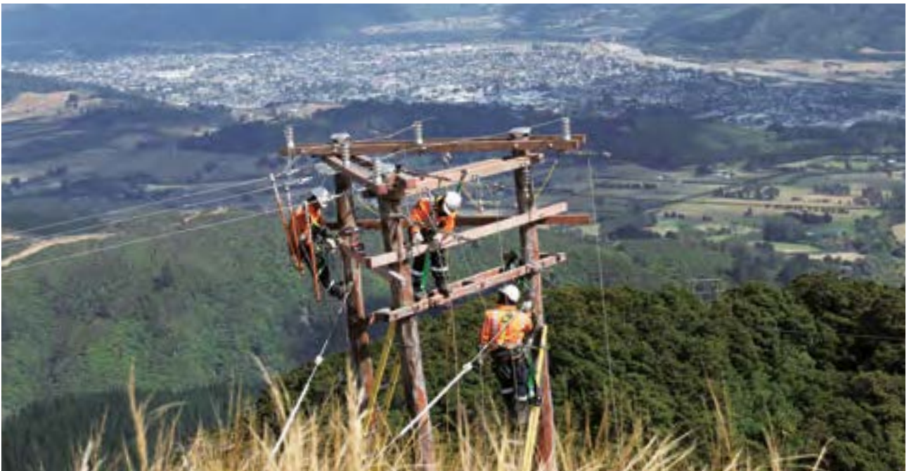
Wellington Electricity 歷時三年之地震應變計劃已於二零二一年首季完成。
